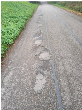
Dégradation de la chaussée avec l'augmentation du trafic
